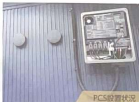
PCS設置状況
